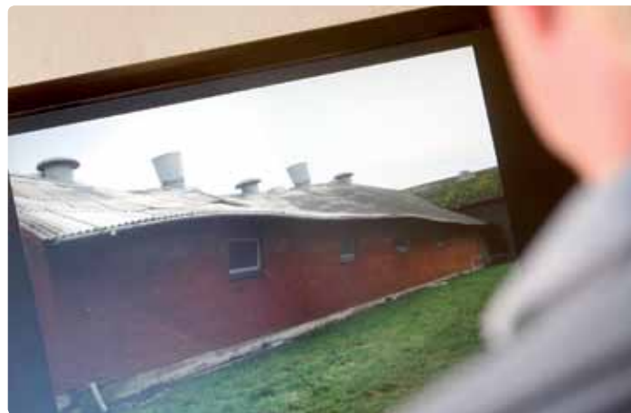
Gert Riis-Vestergaard har billeder af den gamle stald på sin computer. Man ser tydeligt, at murene er ved at kollapse under tagets vægt.
